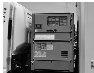
▲ 外付け発電機
